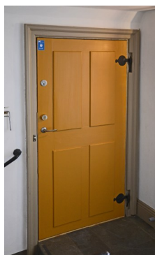
Dörr förstärkt med brand- skyddsmembran och brandskyddsfärg
